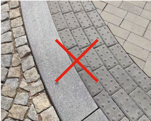
obr. 91 Nesprávně vyřešený detail okolí hmatné dlažby varovného pásu. Není dodržen požadavek na maximální množství spár.
