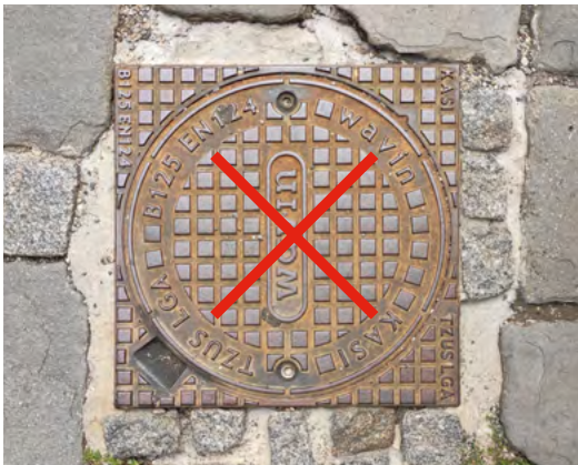
obr. 71 Neprofesionálně provedený vstup dlažbou. Nepřípustné je použití různých formátů dlažby, odlišného druhu kamene i betonové záhlvky.
