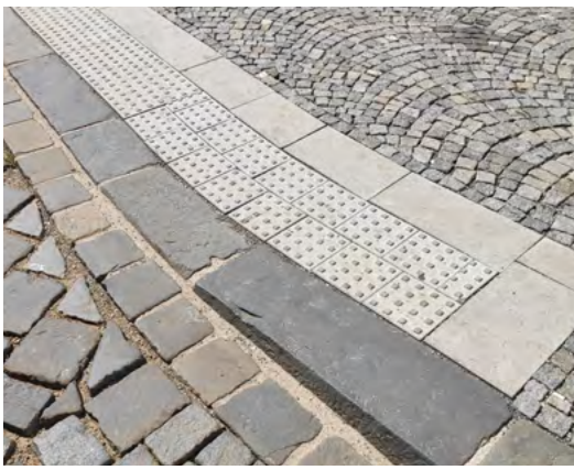
obr. 89 Správně vyřešený detail lemování hmatné dlažby varovného pásu.
