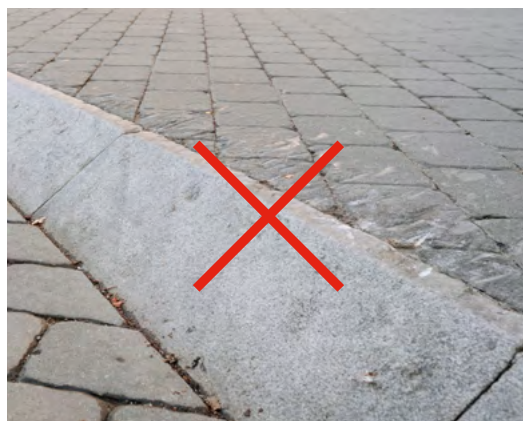
obr. 88 — ul. Jánská Nájezdový obrubník do pěší zóny výšky 10 cm a více je nefunkční pro vjezd vozidel, cyklistů i uživatelů s omezenou mobilitou.
