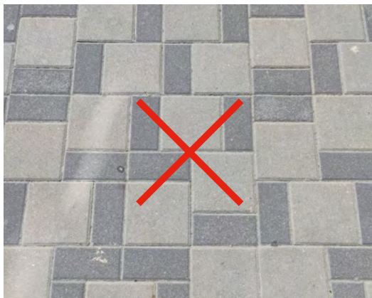
obr. 52 — ul. Josefská Nevhodné použití výrazného barevného kontrastu betonové dlažby.
