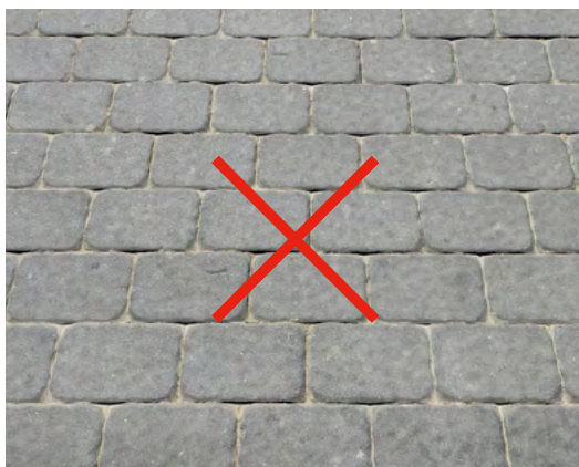
obr. 50 — ul. Jánská Betonová historizující dlažba působí dojmem laciné a nezdařené imitace.
