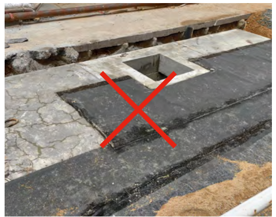
obr. 57 — ul. Solniční Nově vybudovaný podzemní objekt je umístěn tak mělce pod povrchem, že nelze provést standardní konstrukci vozovky. Jde o chybu koordinace projektu i výstavby.
