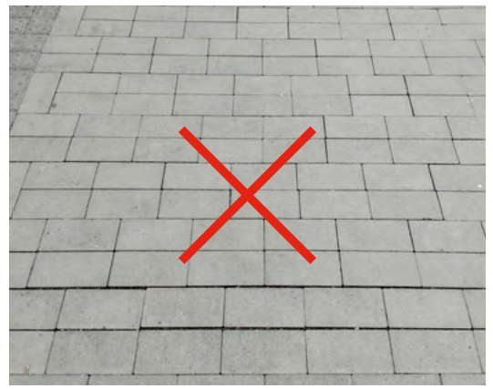
obr. 68 Nesprávně provedená bezfasetová dlažba na sraz má viditelné nerovnosti i různé šířky spár a hrozí jí odlamování hran posunem dlažby při pojezdu.
