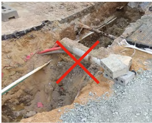
obr. 56 — ul. Česká Mělce uložené kabelové sítě znemožňují správné provedení a hutnění konstrukčních vrstev komunikace.
