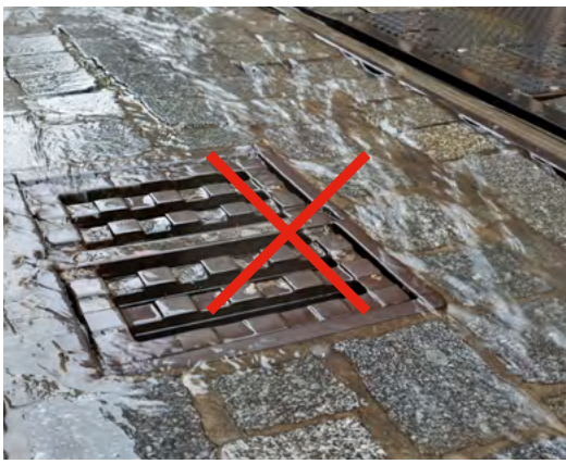
obr. 67 — ul. Masarykova Nevhodně řešené spádování povrchů. Srážková voda nevtéká do vpusť a vymílá spárovací hmotu.
