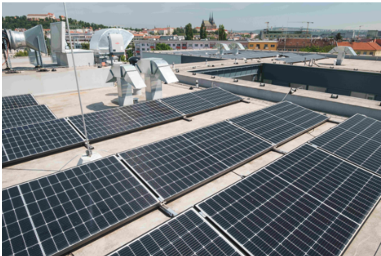
FVE na brněnských střechách
