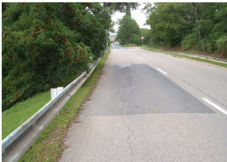
Fotografie č. 1 : Celkový pohled na odlučnou oblast aktivního sesuvu na ulici V rejích v Brně - Chrlicích. Odlučné trhliny a pokles o 10-20 cm v asfaltovém krytu vozovky jsou na snímku dobře patrné. Foto P. Voda, červenec 2011.
