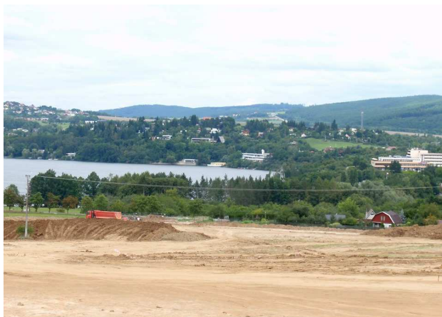
Fotografie č. 2 : Pohled na střední část sesuvného svahu nad ulicí Rakoveckou v Brně - Bystřci. Foto P. Voda, srpen 2014.
