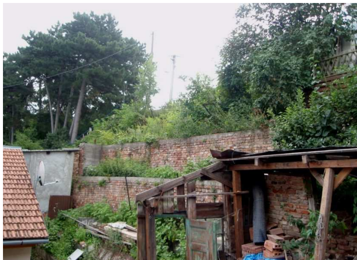
Fotografie č. 1 : Celkový pohled odlučnou oblast sesuvného území nad ulicí Kamenná v Brně - Štýřicích. Koruna sesuvného svahu byla amatérsky zpevněna cihelnými zídkami, které jsou dnes porušené trhlinami. Foto P. Voda, srpen 2011.
