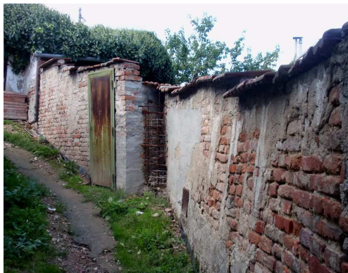
Fotografie č. 2 : Pohled na sesuvem deformovanou zeď v horní části svahu nad ulicí Kamennou v Brně – Štýřicích (domky v tzv. Kamenné kolonii). Foto P. Voda, srpen 2014.
