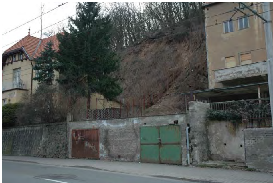
Obr. 1. Pohled na část nestabilizované stěny na ulici Veslařská za dome č.p. 220. Foto O. Krejčí 2011.
