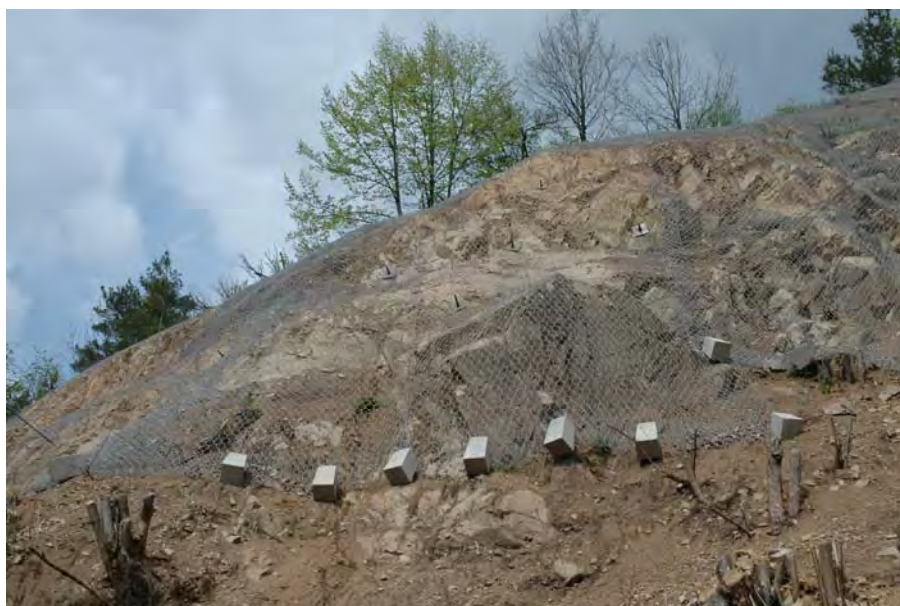
Obr. 2. Detailní pohled na stabilizovanou část lomové stěny za domy v Myslínově ulici č. p. 39, 46 a 47.. Foto O. Krejčí 2008.
