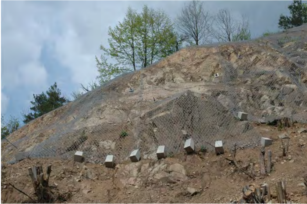
Obr. 12. Detailní pohled na výstavbu stabilizačních opatření za domem Myslínova č. p. 47. Horní část záchytné sítě a hřebíky, kotvicí větší bloky proti odpadnutí. Foto O. Krejčí 2008.
