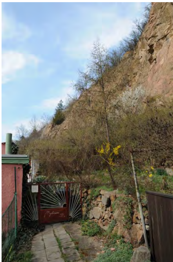
Obr. 5. Pohled na patu stěny za domy v Myslínově ulici v nesanované části. Foto O. Krejčí 11. 4. 2015.
