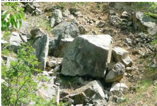
Obr. 15: Severovýchodní okraj lomu zřícený blok (foto A. Havlín, květen 2015).
