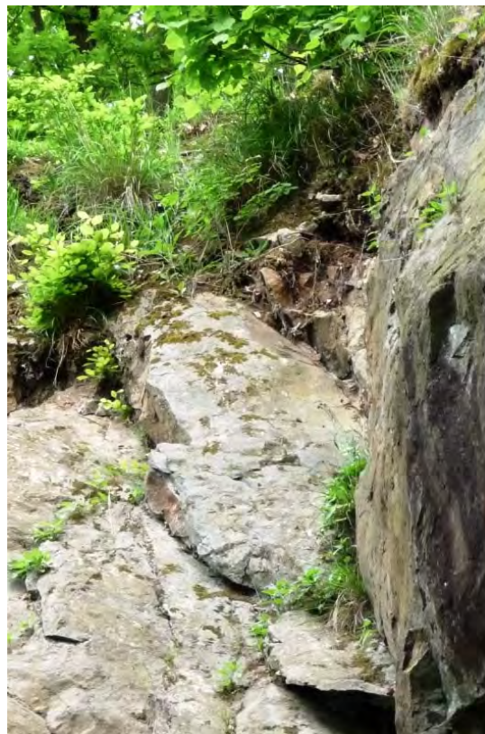
Obr. 14: Uvolněný blok ve východní části stěny (foto A. Havlín, květen 2015).
