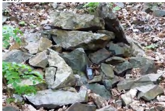
Obr. 12: Drobné balvany z opadu stěny (foto A. Havlín, květen 2015).
