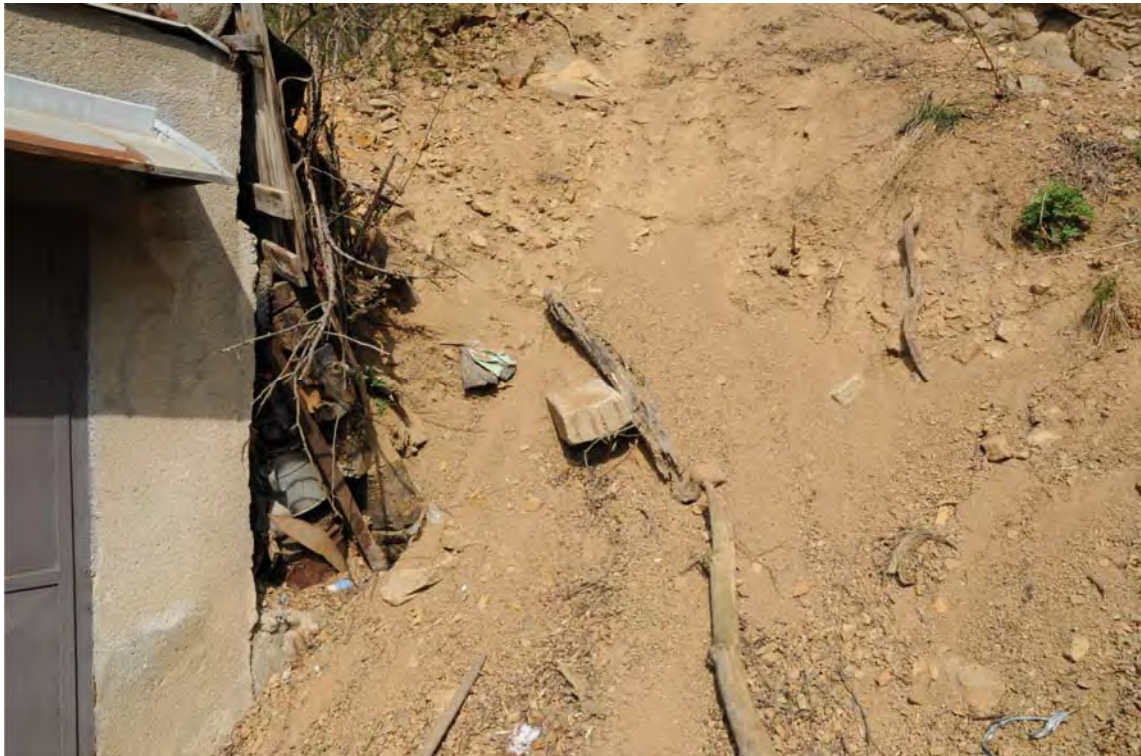
Obr. 3. Pohled na prostor těsně za garážemi se zcela zasypanými provizorními prvky pro zachytávání bloků a kamenů. Foto O. Krejčí 11. 4. 2015.
