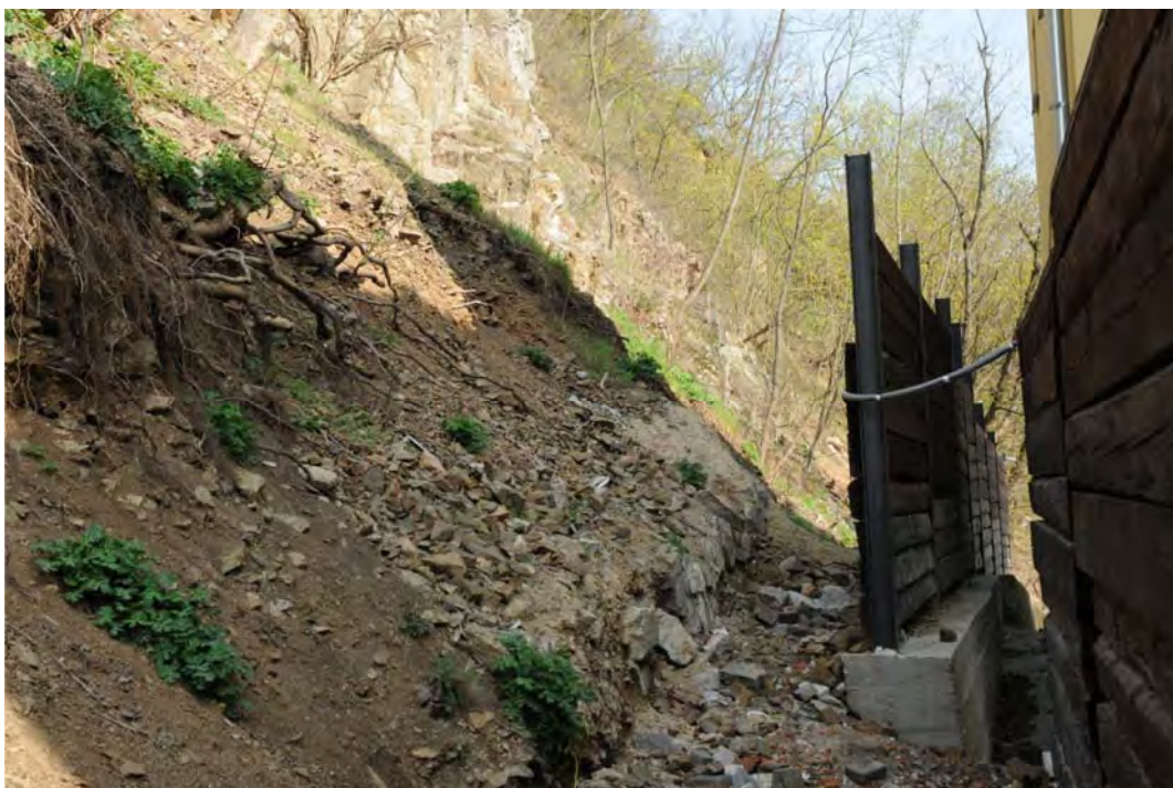
Obr. 4. Pohled na palisádovou stěnu za obytným domem v ulici Veslařská s čersvě napadanými kameny. Foto O. Krejčí, duben 2015.
