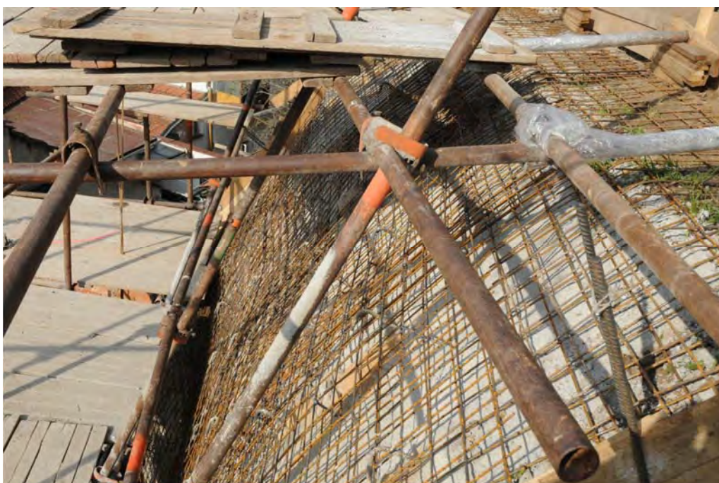
Obr. 16. Výstavba stabilizačních prvků za domem v ulici U Smyčky 6. Foto O. Krejčí, duben 2015.
