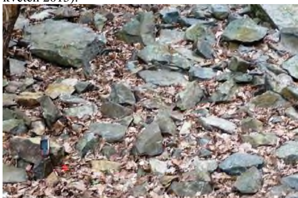
Obr. 11: Drobné balvany z opadu stěny (foto A. Havlín, květen 2015).
