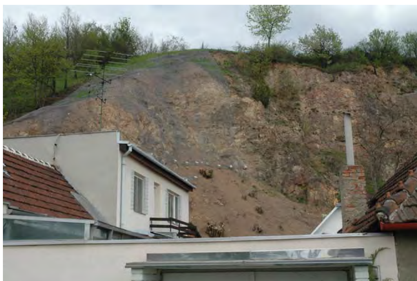
Obr. 1. Celkový pohled na sanovanou část lomové stěny za domy v Myslínově ulici č. p. 39, 46 a 47. Foto O. Krejčí 2008.
