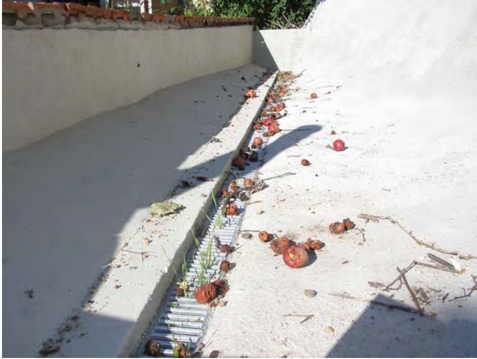
Obr. 5. Odtokový kanál je zasypáván organickým odpadem, spláchnutým při deštích. Foto O. Krejčí, září 2010.
