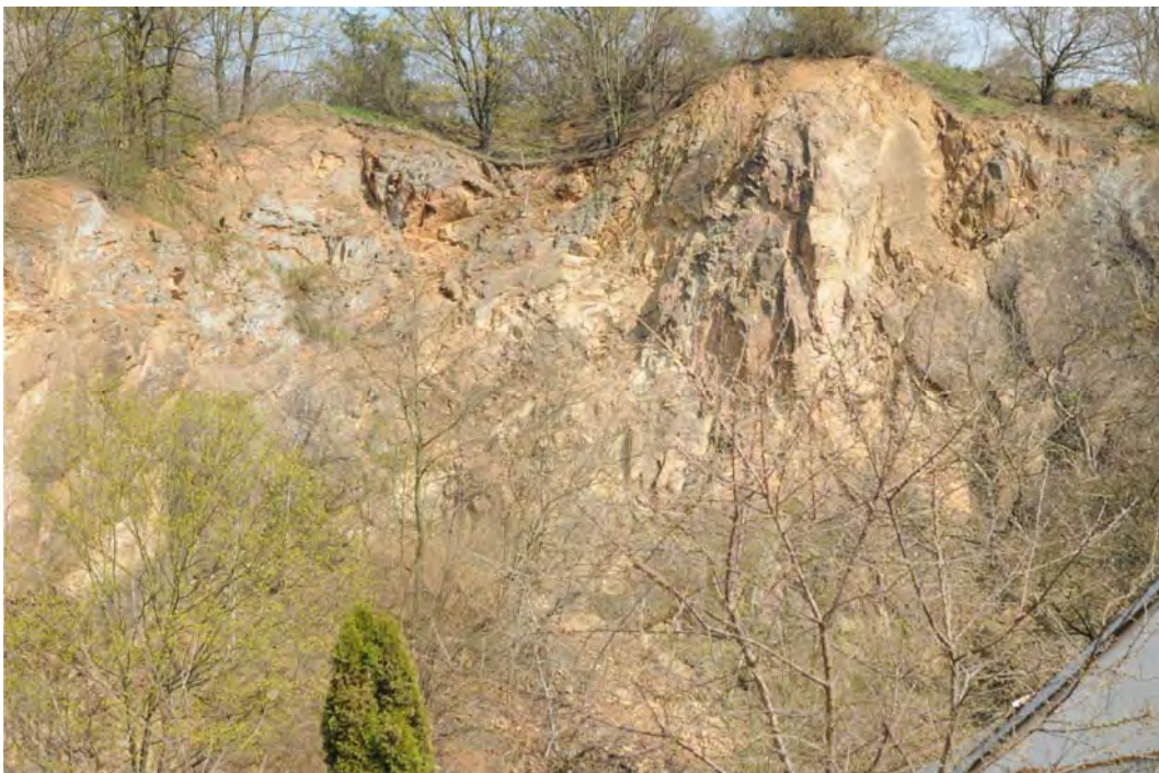
Obr. 2. Detailní pohled na lomovou stěnu za domem v Myslínově ulici č. p. 64. Foto O. Krejčí, duben 2015.
