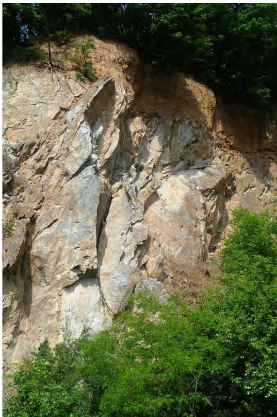
Obr. 29: Severní okraj lomu-detail uvolněného bloku (foto A. Havlín, květen 2015).
