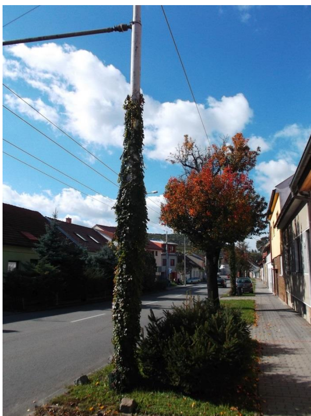
Obr 22 Popínavky na sloupu MHD na ulici Hlavní
