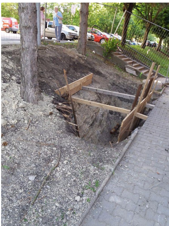
Obr 8 Poškození kořenů při výkopových pracích na ulici Bieblova
