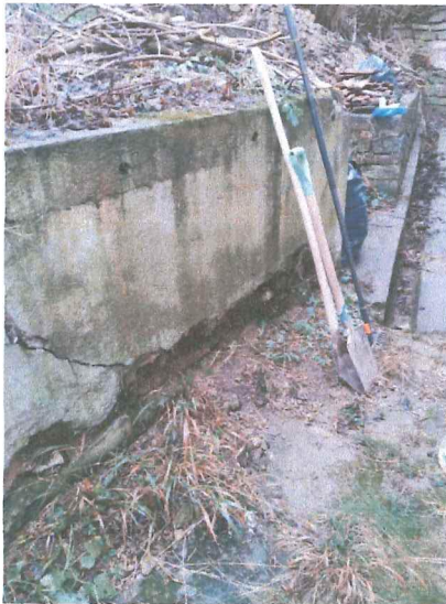
Detail poškozené opěrné zdi a svodového žlabu
