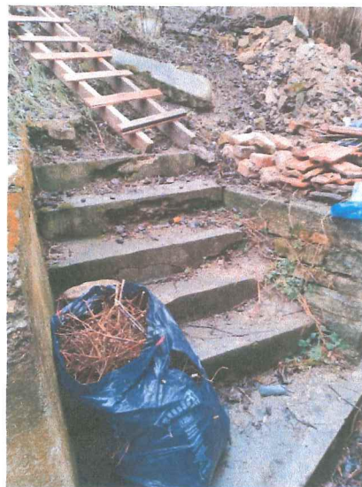
Detail poškozené a částečně chybějící schody
