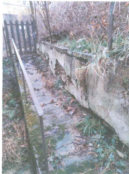
Detail poškození opěrné zdi
