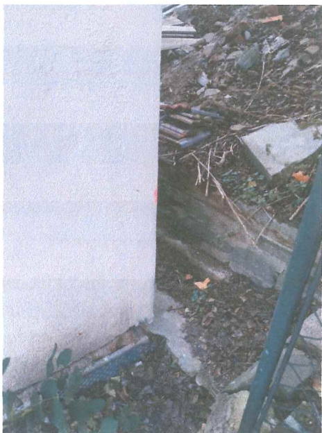
Pohled od vstupu z ulice Hlohová S již viditelným „novým“ stavebním odpadem
