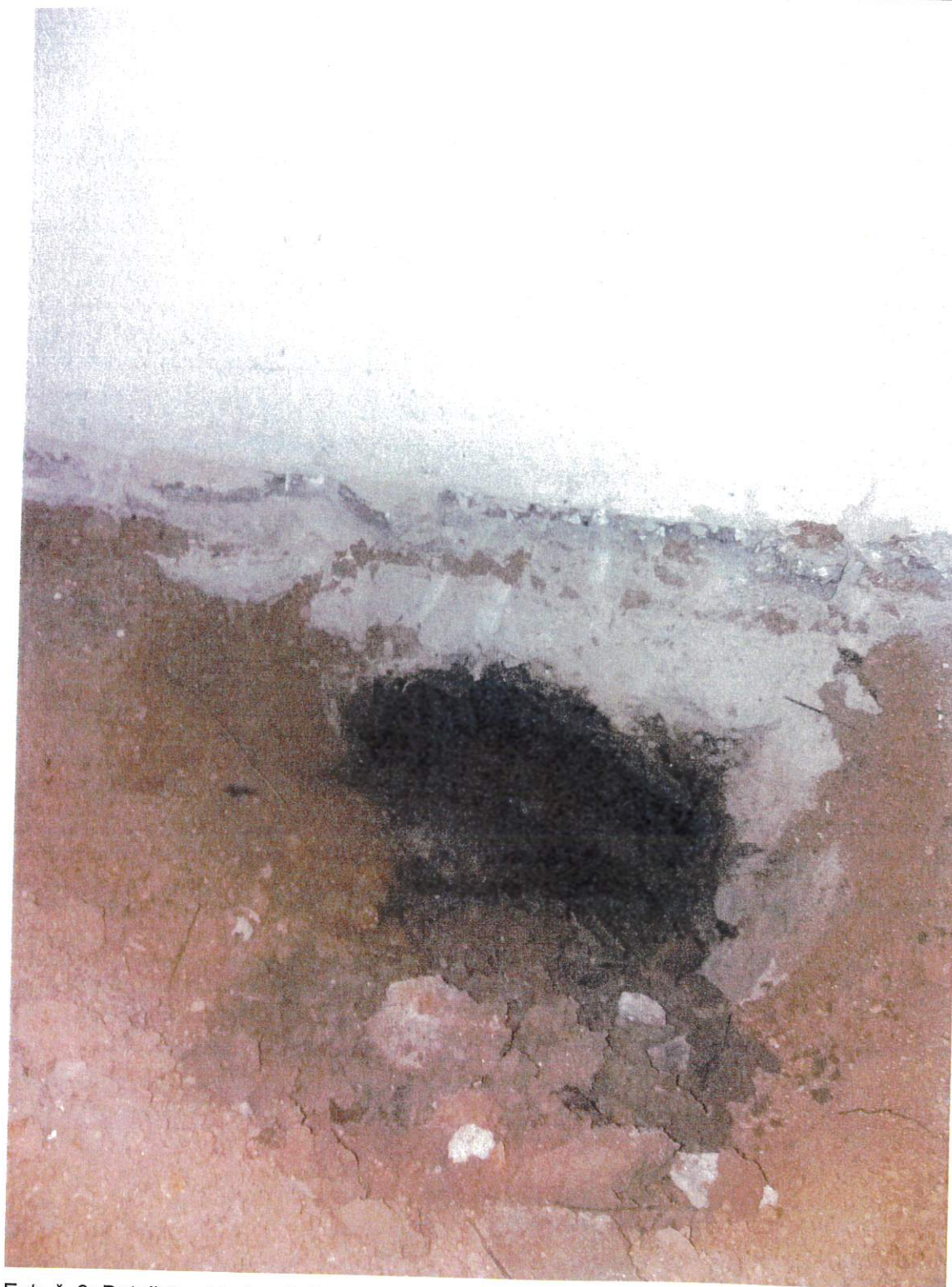
Foto č. 3: Detailní pohled na betonový základ v místnosti číslo 114, 115 a 116 který byl sondou zajištěn u obvodového zdiva směrem do ulice, základ o hloubce cca 150mm
