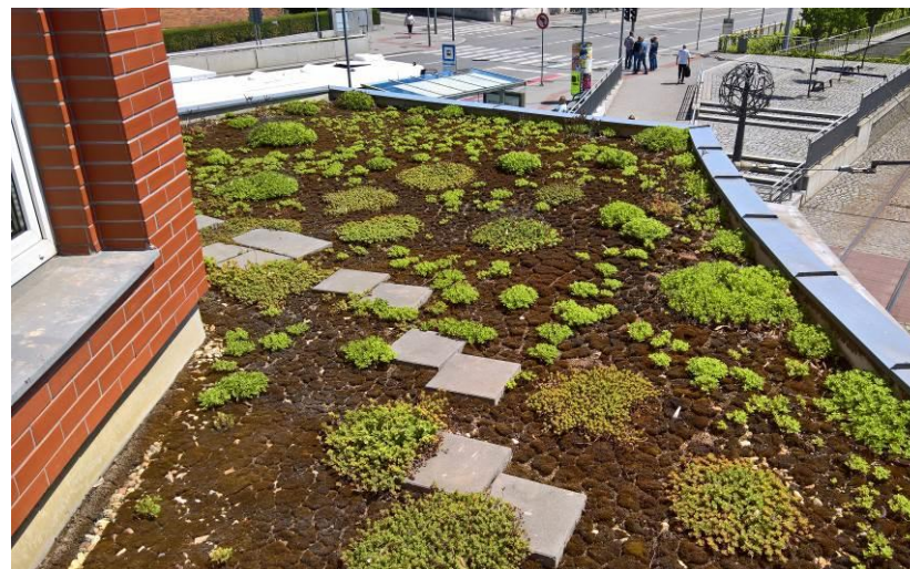
Brno – extenzivní zelená střecha na objektu DPMB
