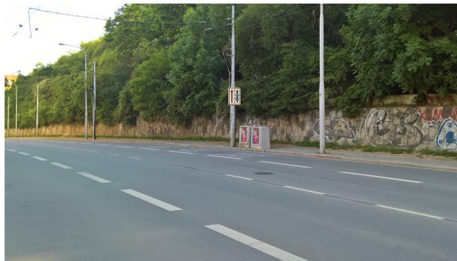
Brno, Úvoz - zeď dlouhá 200 m, výška 2-5 metrů, zvyšuje se směrem dolů k ústí Grohovy
