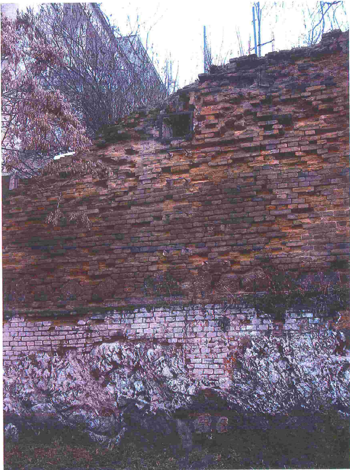
Obr.č.9 – detail levé strany západního křídla / znečištění bílou barvou, degradace zdiva především v horní části pláště
