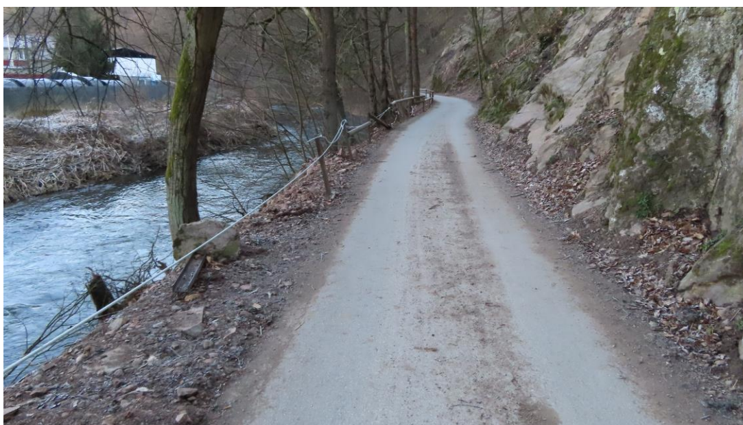
c-V-4 poškození zábradlí u řeky
