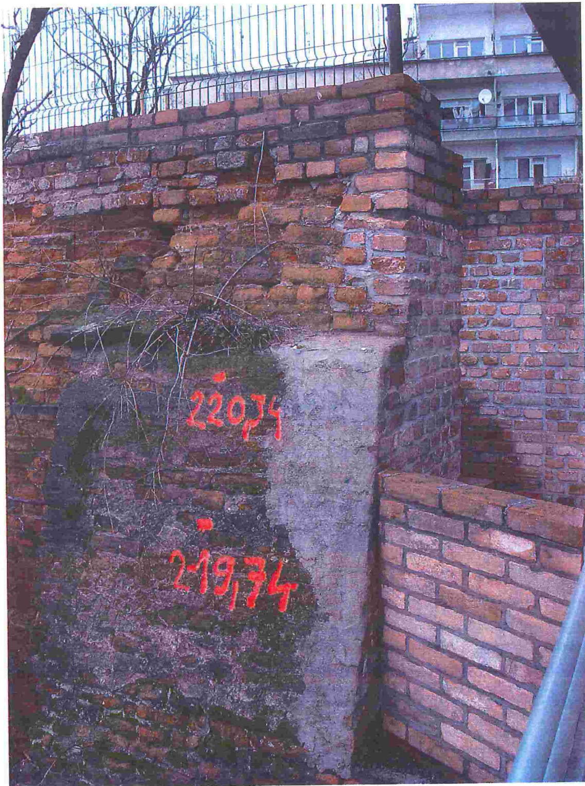
Obr.č.11 – detail pravého konce jižního křídla / navázání schodů a zídky pro vstup na terasu přilehlé kavárny
