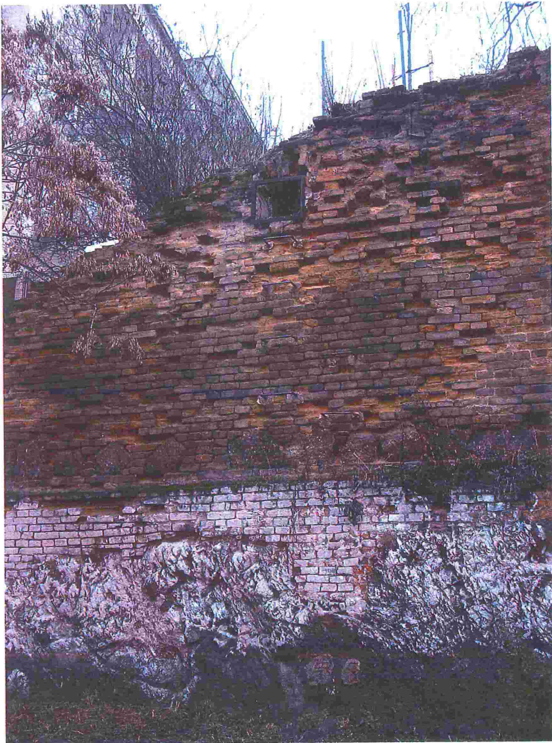
Obr.č.9 – detail levé strany západního křídla / znečištění bílou barvou, degradace zdiva především v horní části pláště
