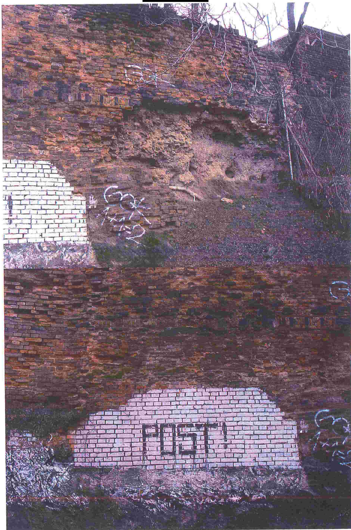
Obr.č.5 – detail vypadaného zdiva západního křídla Obr.č.6 – detail nové, přemalované, vyzdívky
