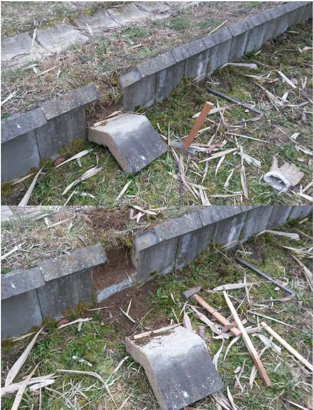
Provizorní oprava zlomeného prefabrikátu pevných zábran na hrázi vyklínováním.
