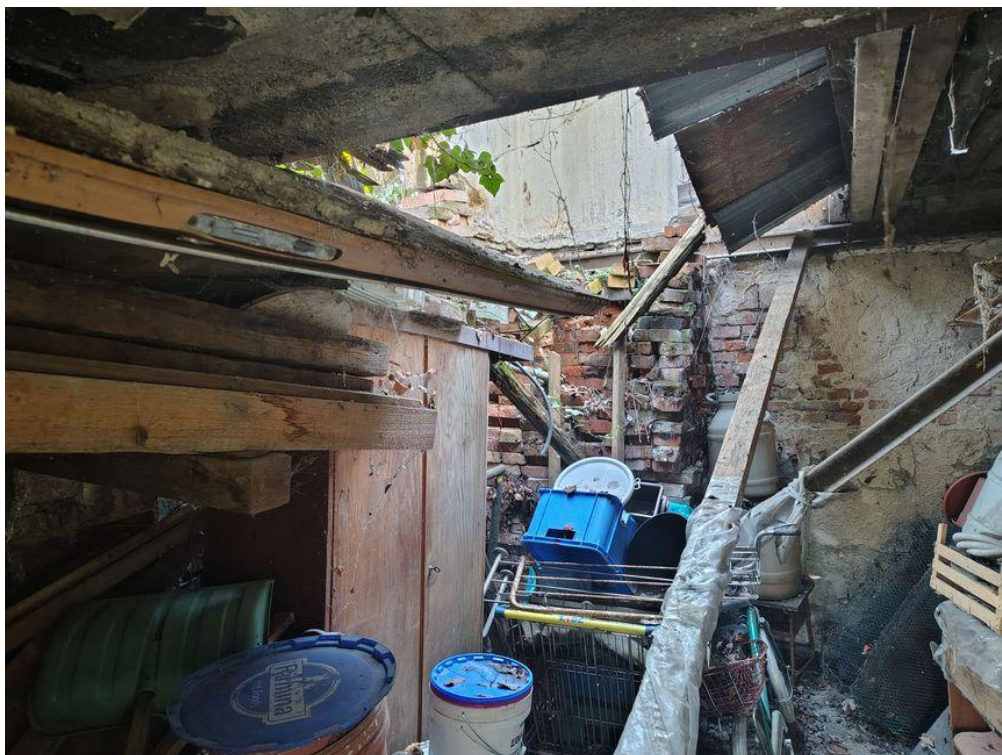
interiér vedlejší stavby - stav nevhodný pro využití
