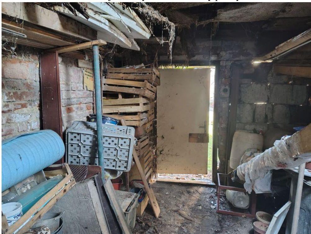
interiér vedlejší stavby - stav nevhodný pro využití
