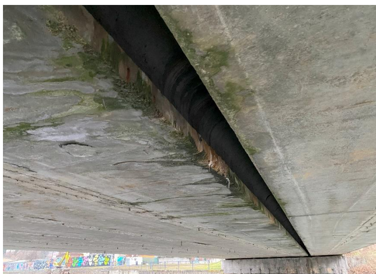
Lokální zatékání mezi nosnou konstrukcí mostu a technologické lávky.
