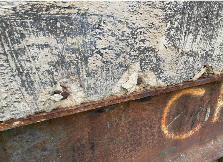
Koroze nosníků úložného prahu a výztuží s nulovým krytím.
