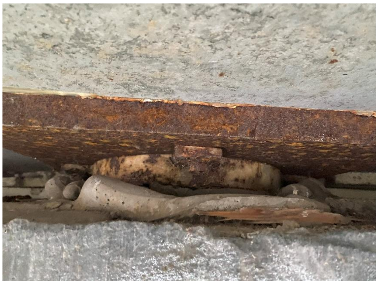
Koroze mostních ložisek.
