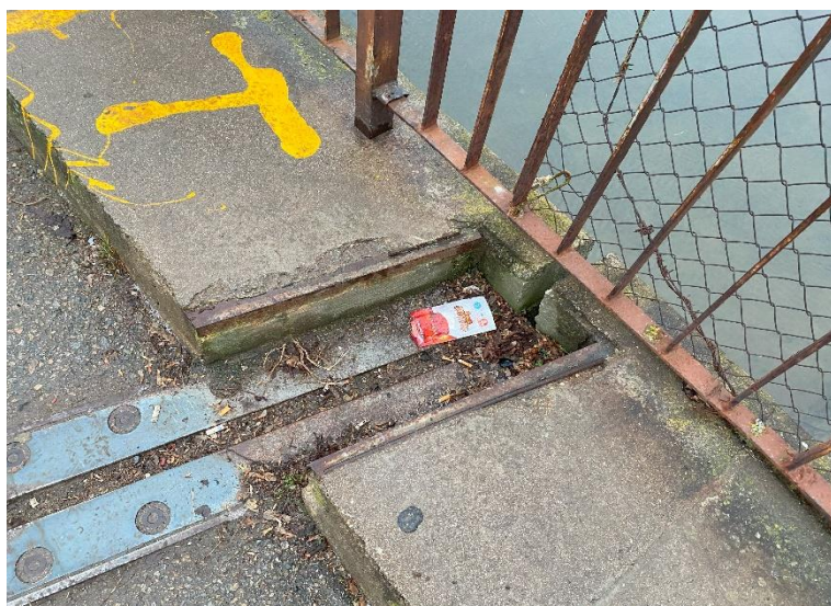
Chybějící krycí deska MZ v levé římse nad OP2, zanešený gumový profil.
