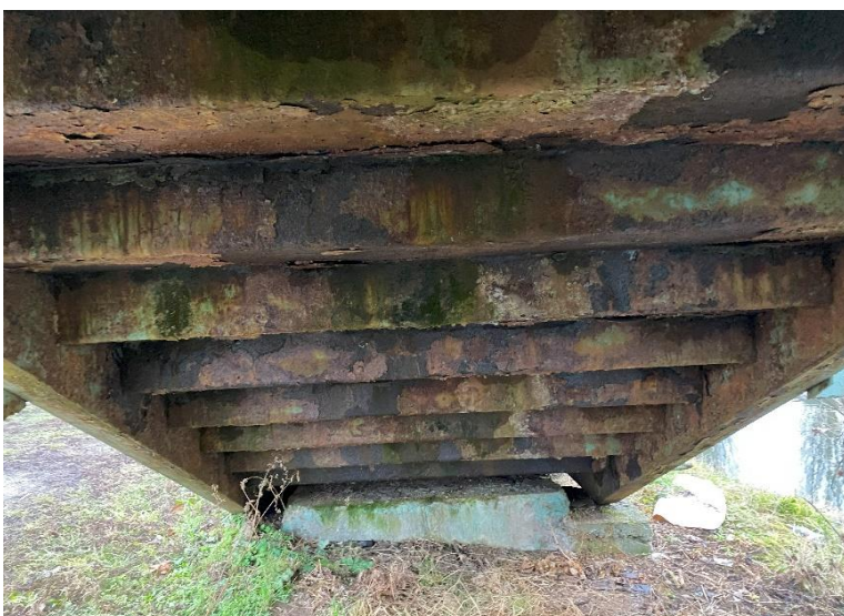
Koroze podhledu schodiště.
