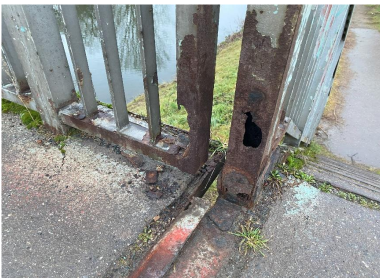
Koroze sloupků zábradlí a krycího plechu MZ u OP1.
