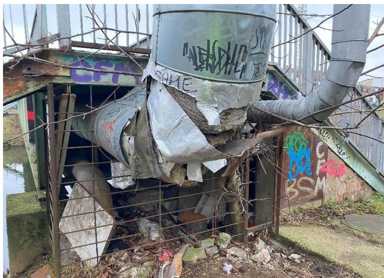
Nepořádek nad OP2, prorůstající strom skrze zajišťovací mříže. Poškozená izolace teplovodu.
