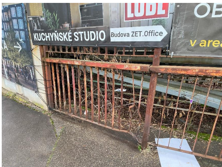
Koroze zábradlí a deformace výplně.
