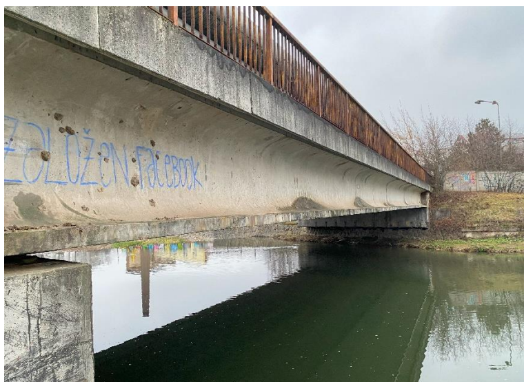
Lokálně potečený bok nosné konstrukce a potečená omšelá římsa.
