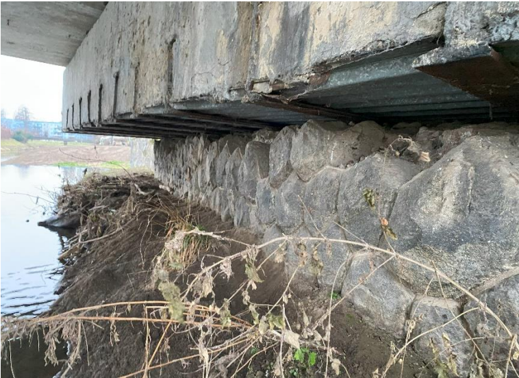
Kaverny v OP2 a koroze nosníků úložného prahu.
