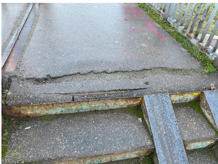
Trhlina v litém asfaltu.
