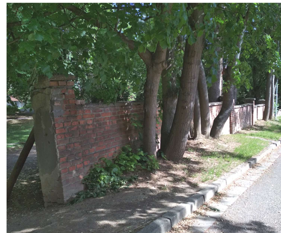
stromy narušující statiku obvodové zdi
