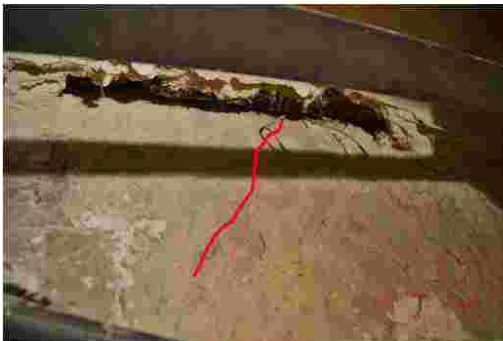
Obr.63-64: Typická trhlina ve sloupu, v místě rámového styčnicku, sonda Sc6M. Na spodním obrázku je pro názornost trhlina zvýrazněna červeně.
