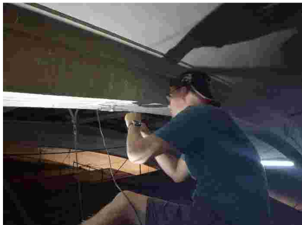
Instalace snímače DH15 ve stropním vazníku
