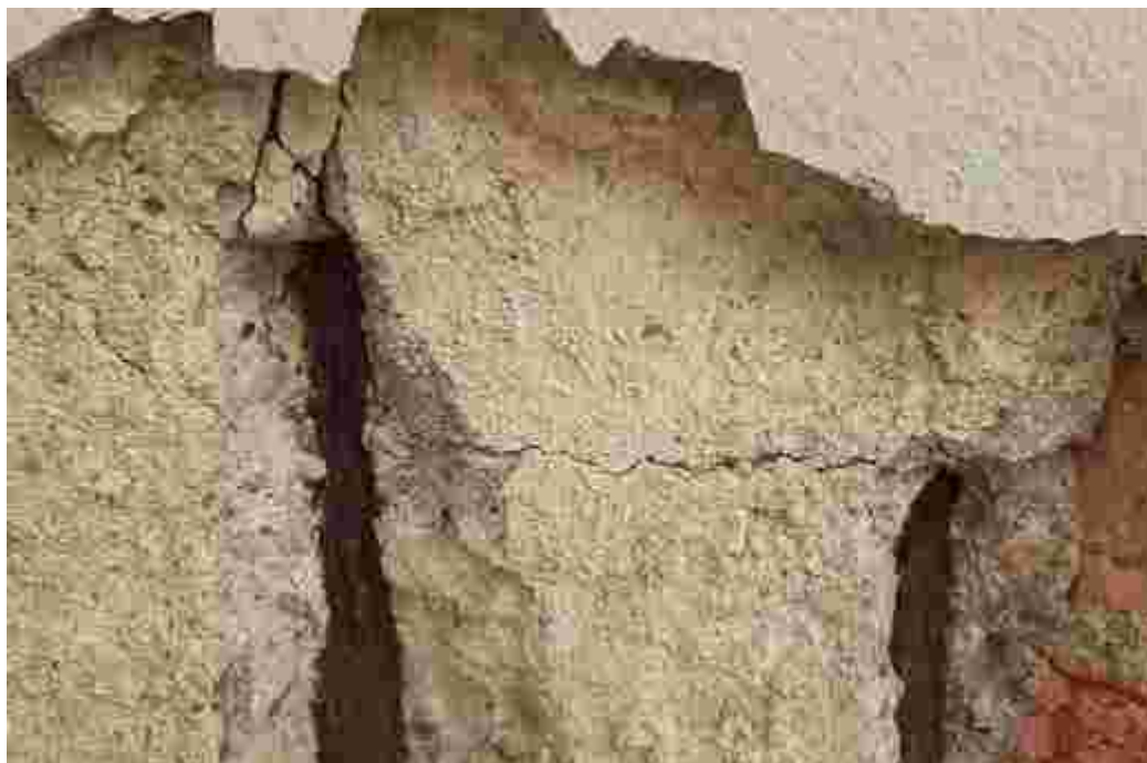
Obr.67: Detail korodované výztuže z předchozího obrázku.
