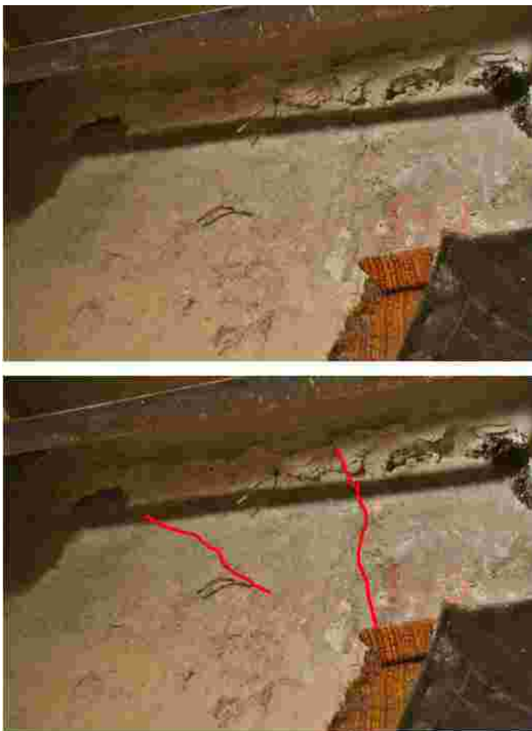
Obr.61-62: Typická trhlina ve sloupu, v místě rámového styčnicku, sonda Sc6J. Na spodním obrázku je pro názornost trhlina zvýrazněna červeně.
